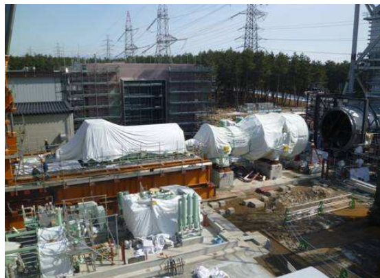
Akita Thermal Unit No.5 (Mar.2012)
