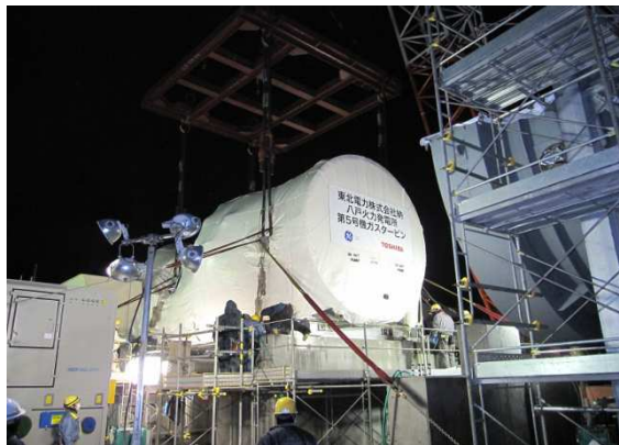
Hachinohe Thermal Unit No.5 (Mar.2012)
