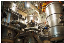
フィルタ付格納容器ベント装置
