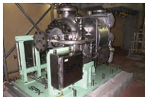
高圧代替注水設備
