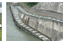
ダムに設置されている魚道
