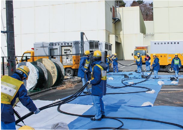
非常時に発電所内へ電源を供給するため、電源車にケーブルを接続する訓練(女川原子力発電所)
