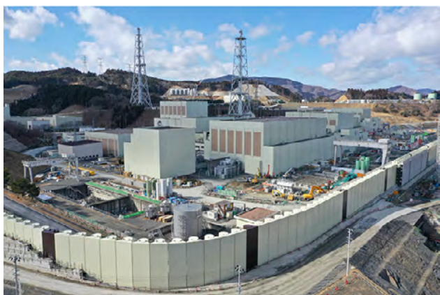
防潮堤（写真手前）の工事が進捗している（女川原子力発電所）
