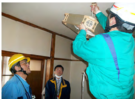
一人暮らし高齢者宅電気設備点検・清掃活動 十和田電力センター
