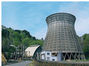
松川地熱発電所(岩手県八幡平市)
