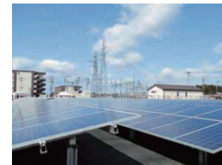
石巻蛇田太陽光発電所 (宮城県石巻市)
