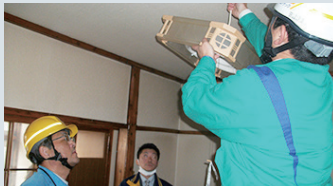
一人暮らし高齢者宅電気設備点検・清掃活動 十和田電力センター
