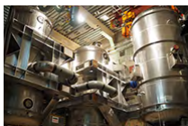
フィルタ付格納容器ベント装置
