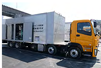
ガスタービン発電機
