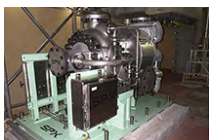
高圧代替注水設備
