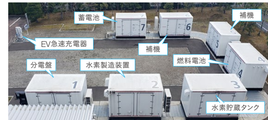
水素製造システム 研究開発センター（仙台市青葉区）
