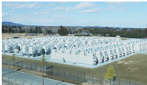
南相馬変電所大容量蓄電池システム外観
