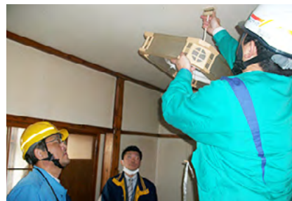
一人暮らし高齢者宅電気設備点検・清掃活動 十和田電力センター
