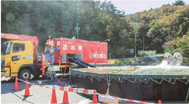
非常時に原子炉や使用済燃料プールに注水できる「大容量送水ポンプ車」による送水訓練(女川原子力発電所)
