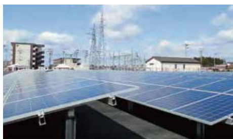
石巻蛇田太陽光発電所 (宮城県石巻市)
