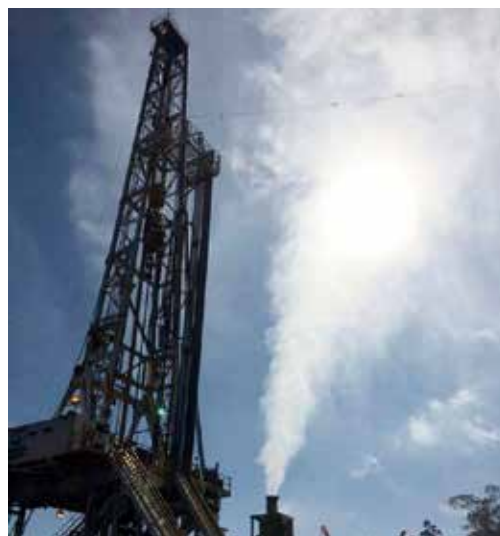
建設工が進むランタウ・デダップ地熱発電所（インドネシア共和国）
