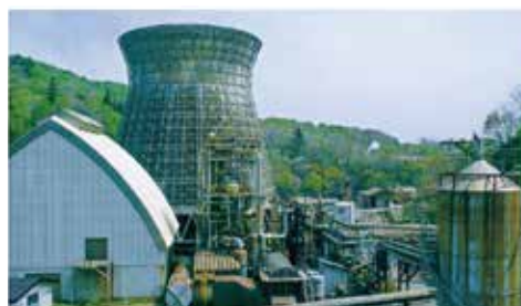
松川地熱発電所 (岩手県八幡平市)
