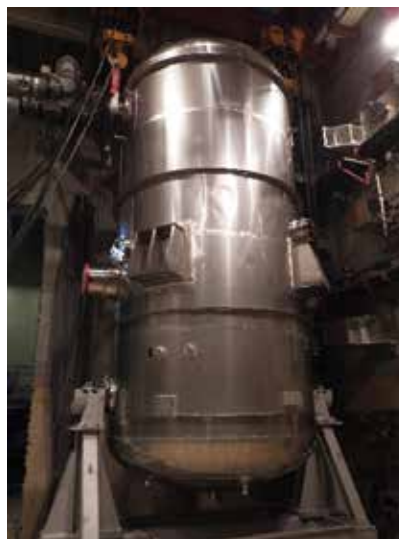
フィルター付格納容器ベント設備※の設置工事 (女川原子力発電所)
