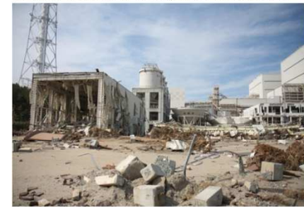
【原町火力発電所】
