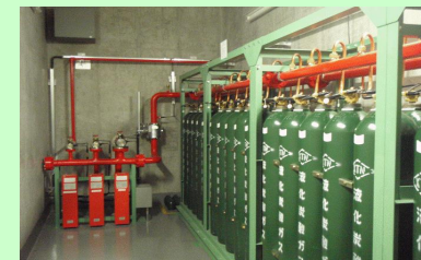
自動消火設備
