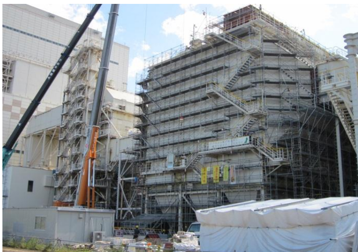
③電気集塵器(2012年10月)
