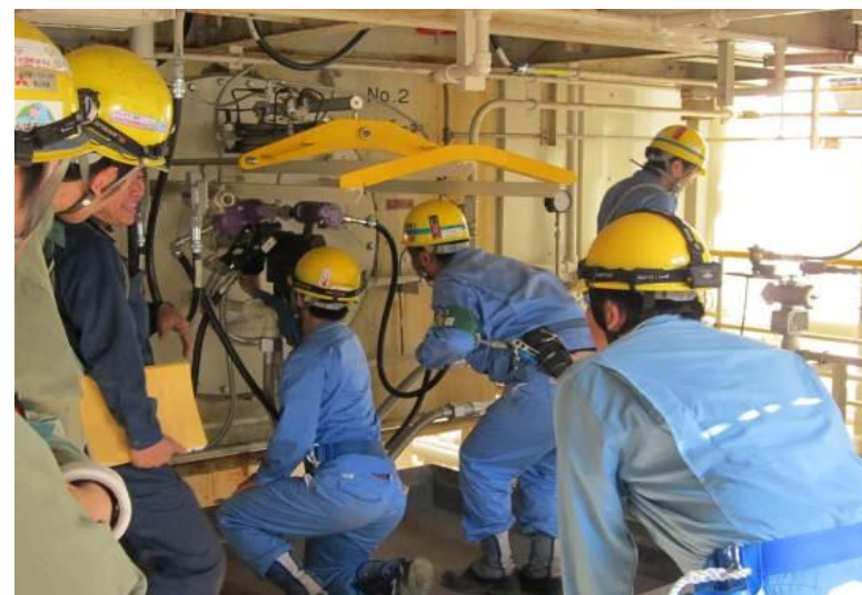
④所内ボイラ試運転(2012年10月)
