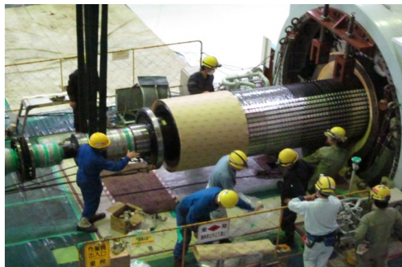
1号機 発電機点検状況
