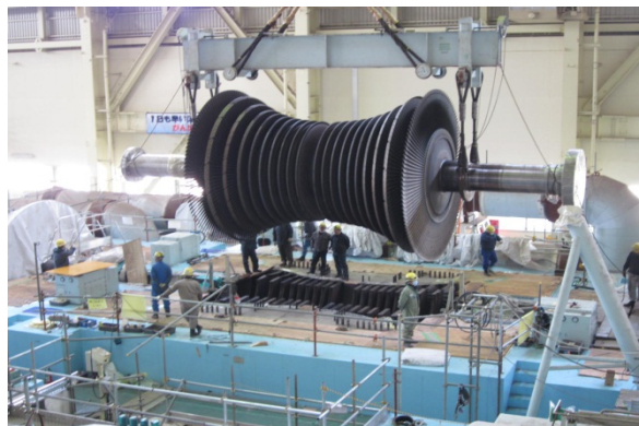
2号機 蒸気タービン点検状況
