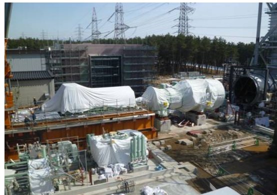
秋田火力発電所 5号機 (2012年3月)
