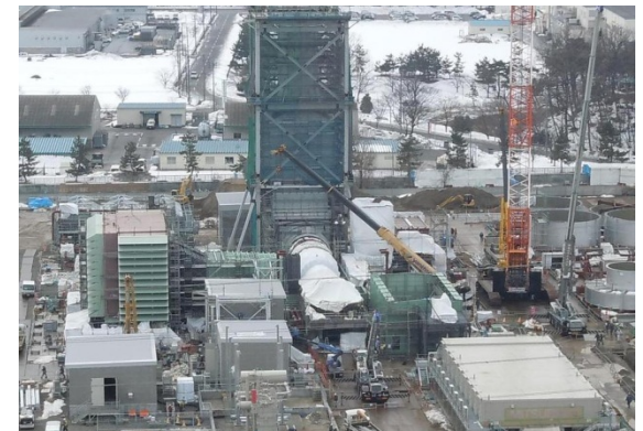
東新潟火力発電所 5号機 (2012年3月)
