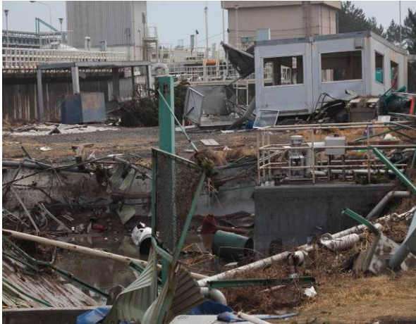
新仙台火力発電所 (宮城県 仙台市)
