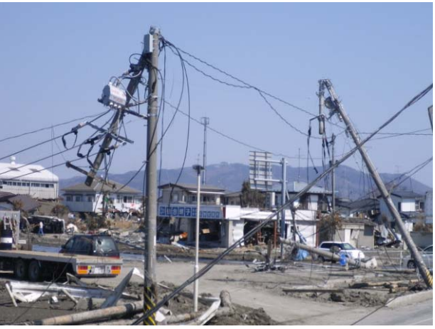
配電設備 (宮城県 石巻市)
