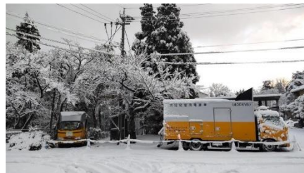
高圧発電機車による応急送電
