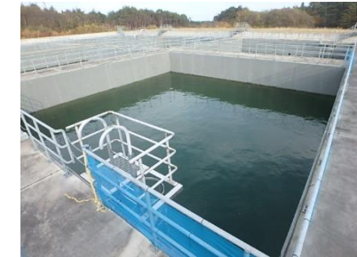
東通原子力発電所 淡水貯水槽
