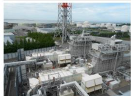
新潟火力発電所5号系列
