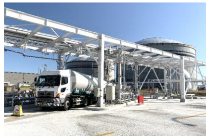
新仙台火力発電所のLNG出荷設備
