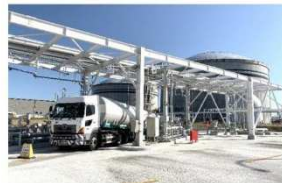
新仙台火力発電所のLNG出荷設備
