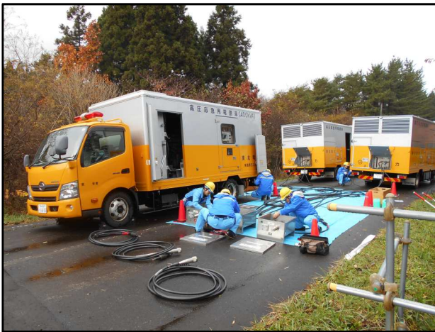
電源車による電源確保訓練
