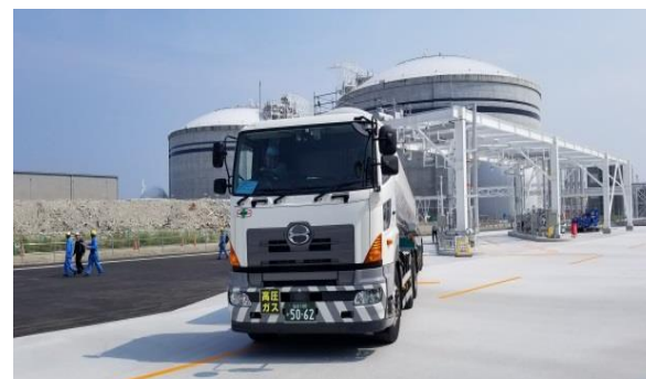
新仙台火力発電所のLNG出荷設備
