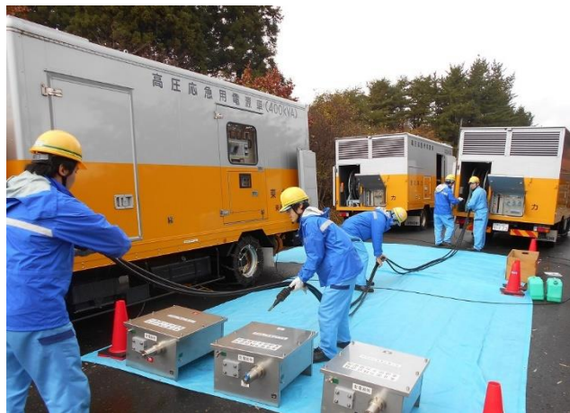
電源車による電源確保訓練
