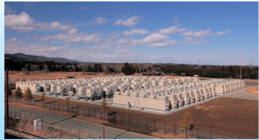
南相馬変電所 蓄電池システム
