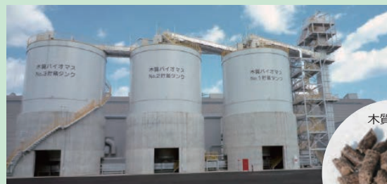
木質バイオマス燃料設備
