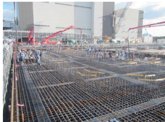
能代火力発電所3号機基礎工事でのコンクリート大量打設の状況
