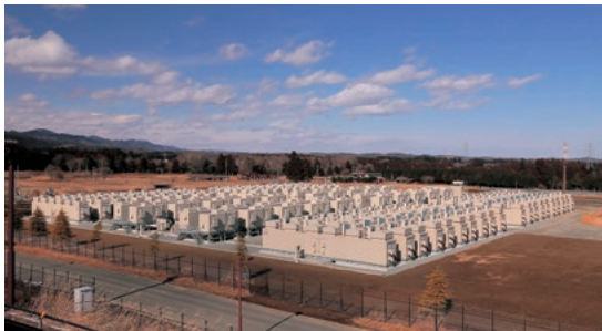
南相馬変電所 蓄電池システム
