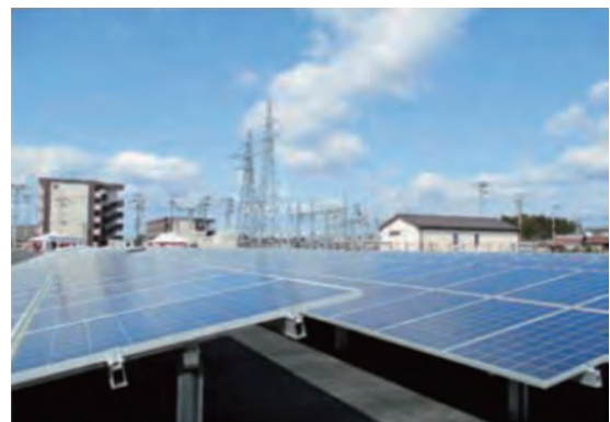
石巻蛇田太陽光発電(宮城県石巻市)
