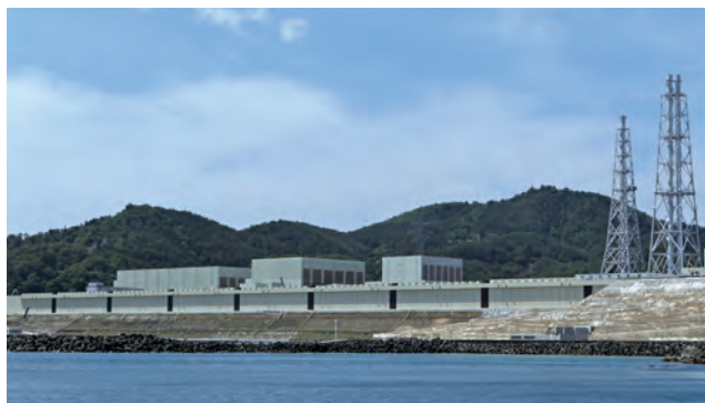
海拔29m、全長約800mにもおよぶ防潮堤の設置工事を実施している女川原子力発電所（2017年6月撮影）
