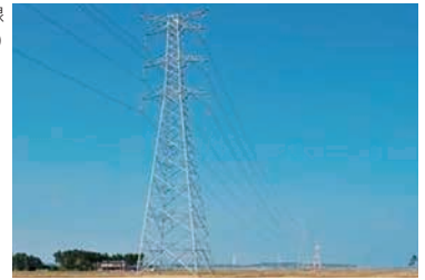
原町火力線 (福島県南相馬市)
