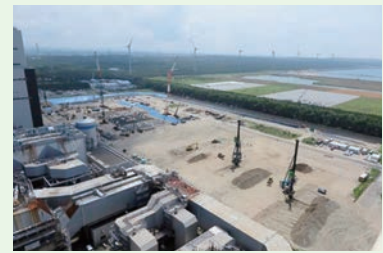
能代火力発電所3号機建設工事状況 (発電機本館基礎他工事)
