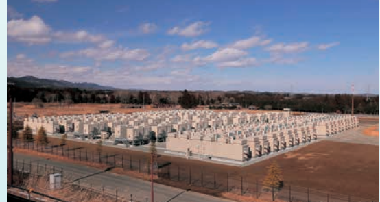
南相馬変電所 蓄電池システム
