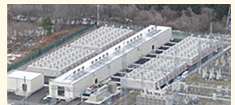
西仙台変電所 蓄電池システム
