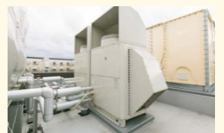
ヒートポンプ機器
