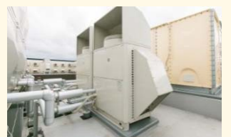
ヒートポンプ機器
