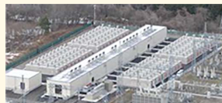
西仙台変電所 蓄電池システム
