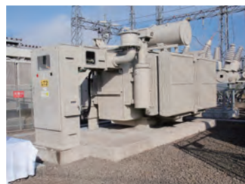
梁川変電所に導入された環境調和型変圧器(福島県伊達市)
