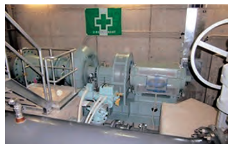
送水管につなげられた発電設備
