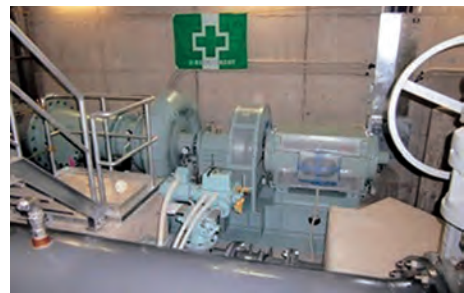
送水管につなげられた発電設備
