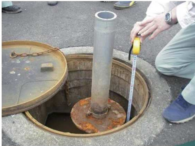
写真-5.22 堤体の沈下により約40cm突出した層別沈下計のパイプ
