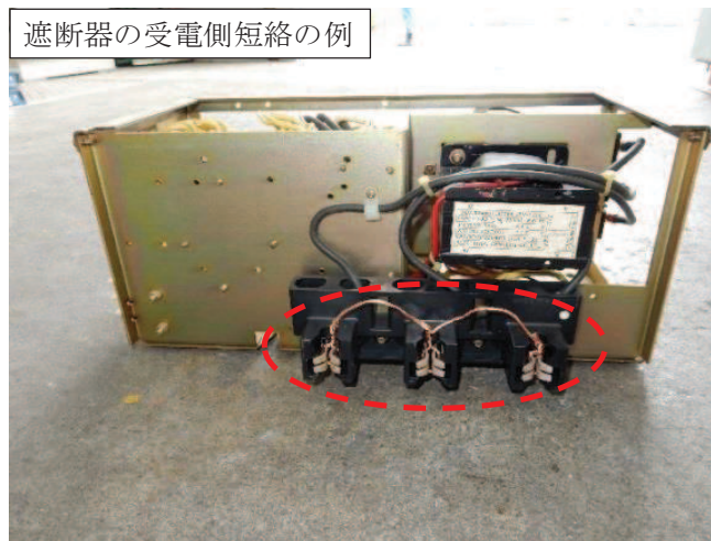
参考図2-5 遮断器の短絡箇所(MCC試験時)
