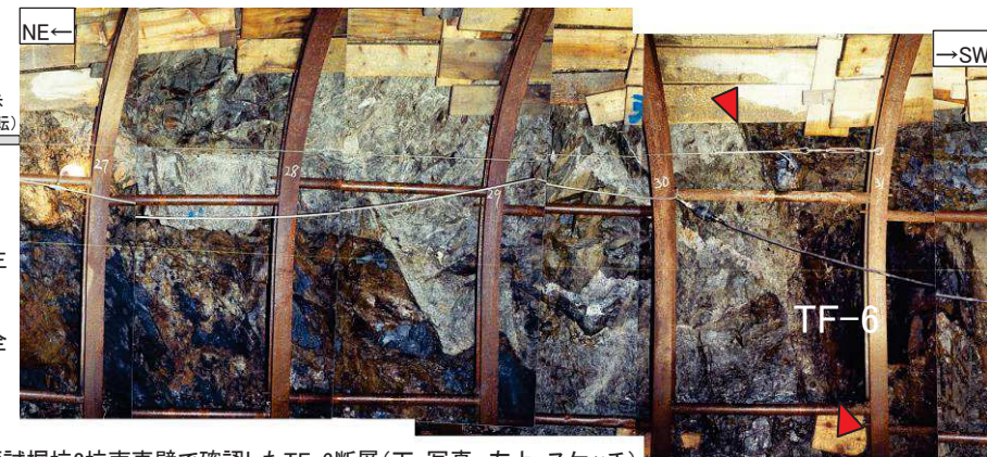
3号炉試掘坑2坑南東壁で確認したTF-6断層(下:写真, 左上:スケッチ)
