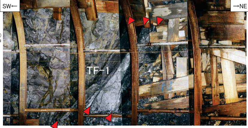
3号炉試掘坑2坑北西壁で確認したTF-1断層(左:スケッチ, 右:写真)
