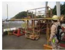
CS6_鋼製架台(1)
