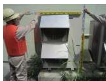
E3_業務用室外機(2)
