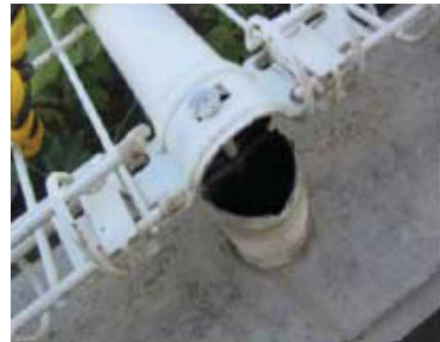
支柱部の破断
