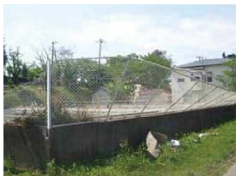
フェンスの被害状況
