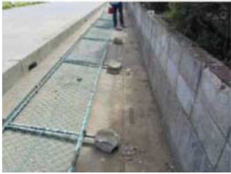
フェンスの倒壊
