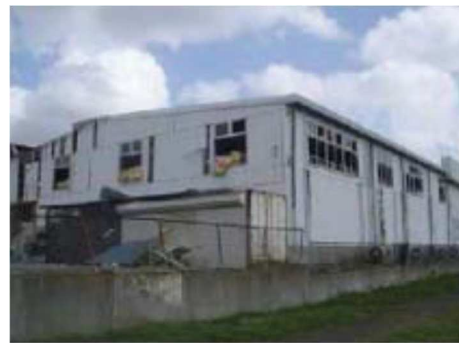
窓ガラスの破損
