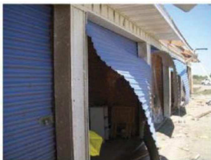
シャッターの被害
