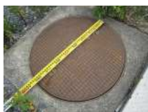
E3_マンホール蓋(2)
