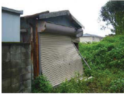
シャッターの外れ
