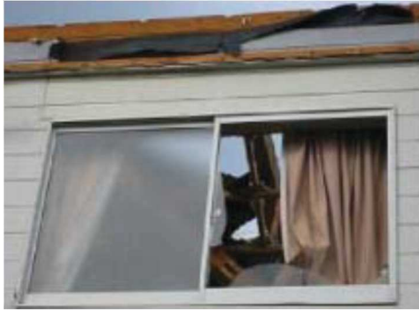
窓ガラスの損壊
