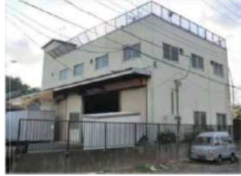
屋上フェンスの被害
