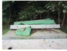
NE1_コンクリート製容器 (2)
