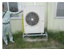
N2_業務用室外機
