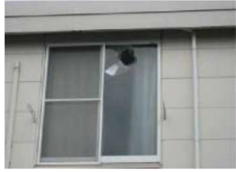
窓ガラスの飛来物衝突痕
