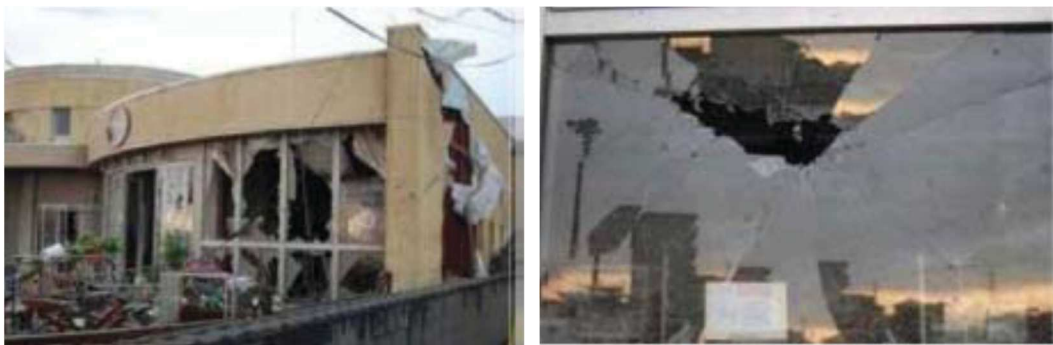
店舗の窓ガラスの被害状況
