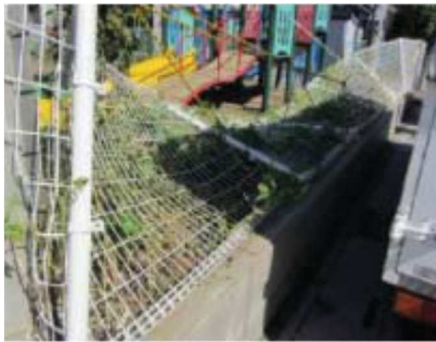
フェンスの倒壊
