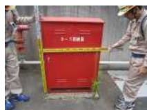
CS6_ホース格納箱(1)
