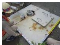
E3_鋼製ハッチカバー(2)
