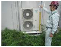
N4_業務用室外機
