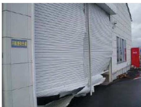
シャッターの破損
