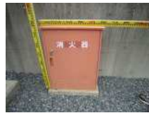
CN4_消火器格納庫(1)
