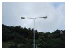
N2_屋外照明
