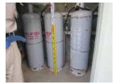
CS5_ガスボンベ
