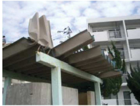
屋外トイレ屋根の損傷
