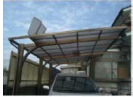
カーポート屋根の破損
