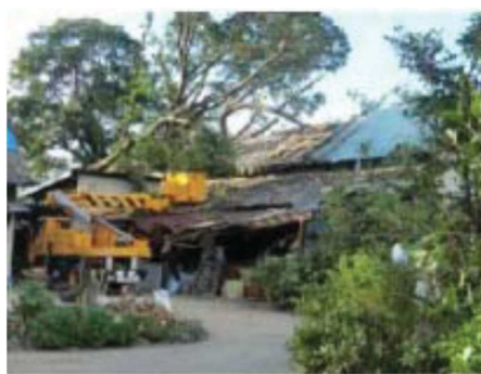
樹木の倒壊による小屋組の被害
