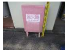
CS5_消火器格納庫(1)
