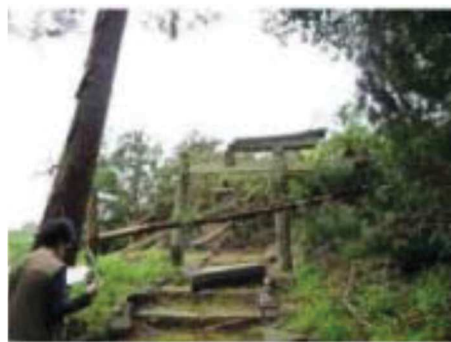
倒木の折損と鳥居の被害
