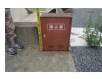
CN3_消火器格納庫(1)
