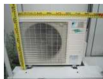
CS6_家庭用室外機(1)
