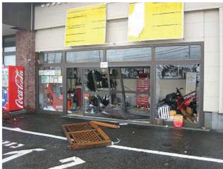
エントランスのガラス破損
