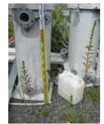
E4_鋼製タンク
