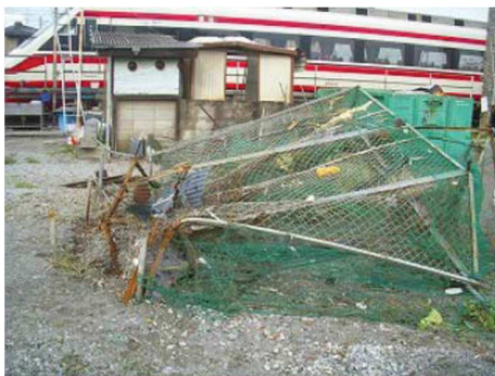
フェンスの著しい変形
