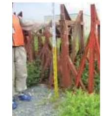
E4_鋼製架台(1)
