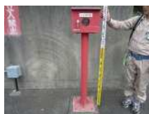
CS6_火災報知器格納箱
