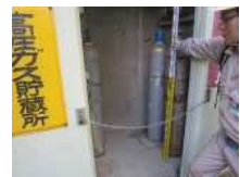
CS9_ガスポンベ
