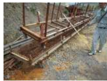
E4_鋼製架台(2)
