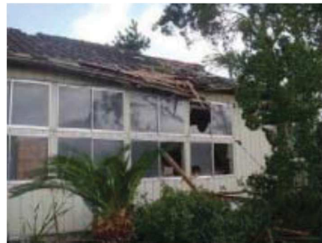
倉庫の窓ガラスと屋根の被害状況
