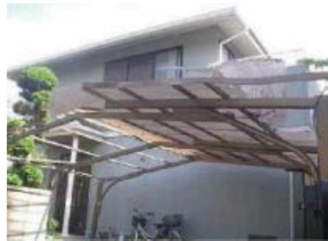
カーポートの被害
