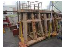
CS6_鋼製架台(2)
