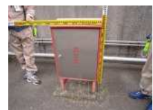
CS6_消火器格納庫(2)
