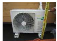
CN4_家庭用室外機(1)
