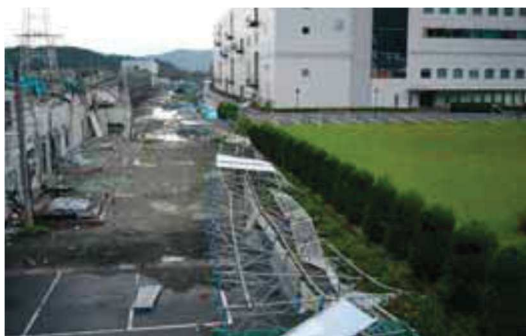
仮設足場の倒壊
