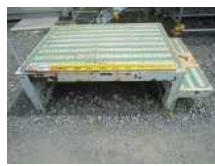
N5_鋼製架台(3)
