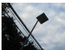
N6_屋外照明
