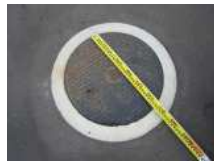
E4_マンホール蓋(1)
