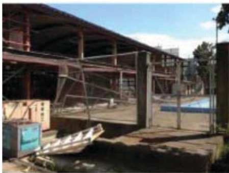
フェンスの被害（工事中の建築物）
