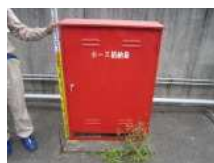
CS6_ホース格納箱(2)
