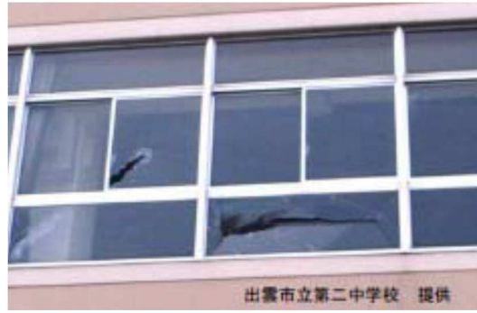
体育館窓ガラスの破損
