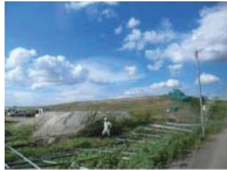
フェンスの被害
