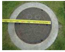
CN3_マンホール蓋
