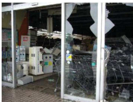
エントランスの窓ガラスの破損
