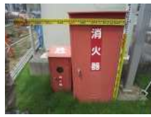
CS8_消火器格納庫(1)
