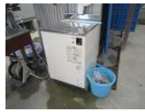
N5_電気温水器
