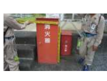
CS5_消火器格納庫(2)
