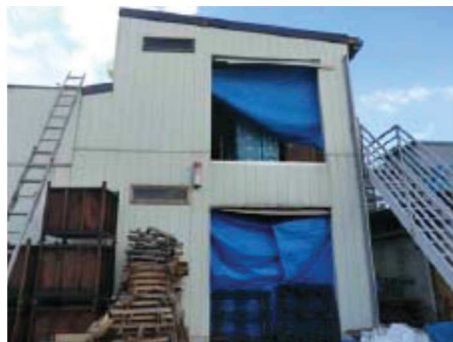
シャッターの被害
