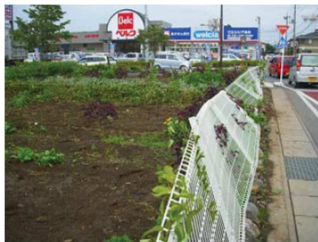
フェンスの変形
