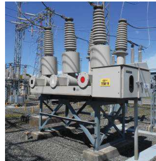
西石巻変電所 (VCB)
