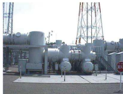
石巻変電所 (GIS)
