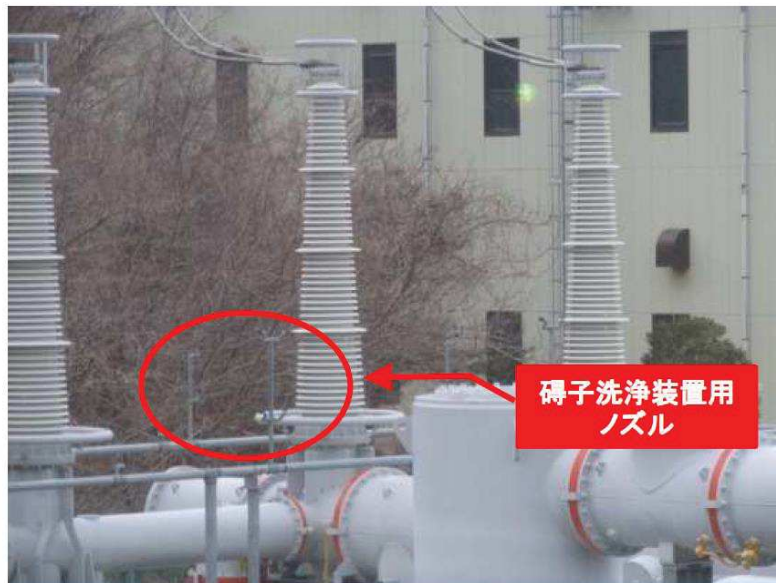
第 2.2.4-36 図 碍子洗浄装置外観
