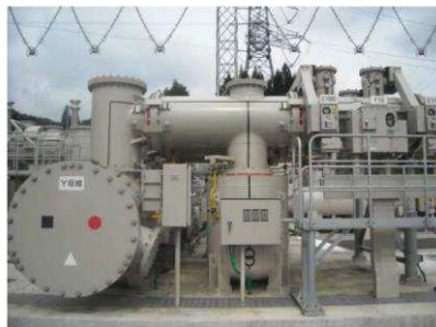
宮城中央変電所 (GIS)
