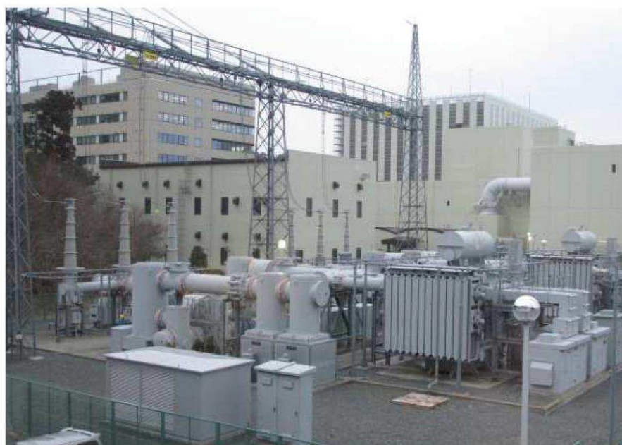
第 2.2.4-6 図 開閉所設備外観
