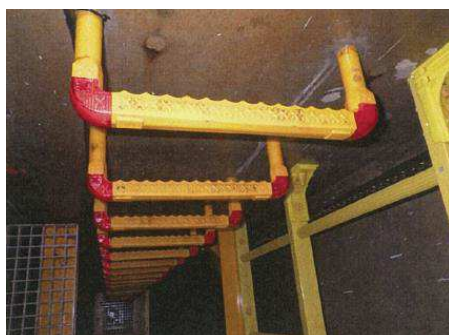
写真C 揚水井戸⑤(中段部) 2017/3/17撮影
