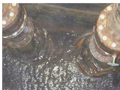
2号炉揚水ポンプの例(揚水井戸⑥)
