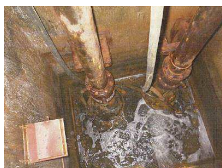
写真D 揚水井戸⑤(下段部) 2017/3/17撮影
