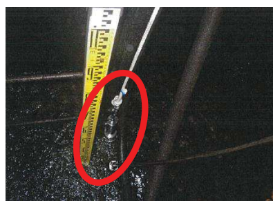
3号炉水位計の例(揚水井戸⑦)
