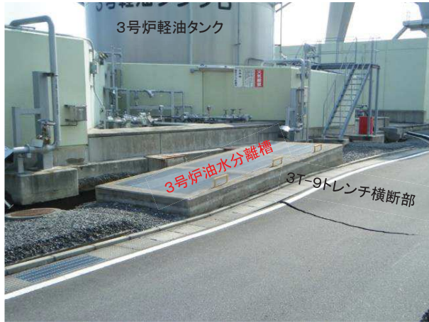
写真① 沈下発生状況
