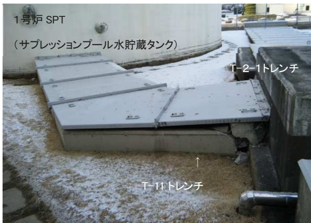
写真㊦ 沈下発生状況
