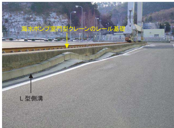
写真㉔ 沈下発生状況
