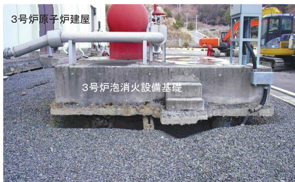
写真⑥ 沈下発生状況
