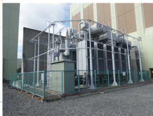
図 主変圧器外観
