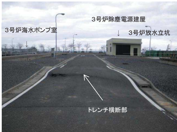
写真㉓ 沈下発生状況
