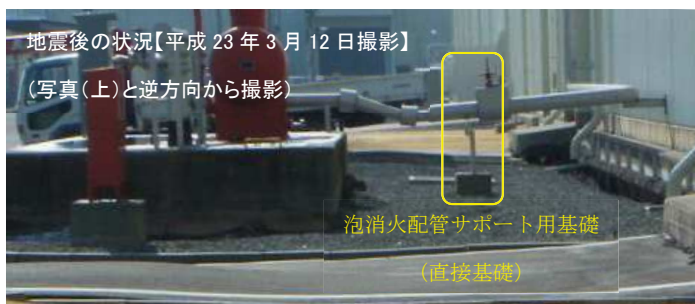
写真⑥' 沈下発生状況
