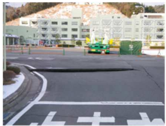
被害箇所④ 段差発生状況
