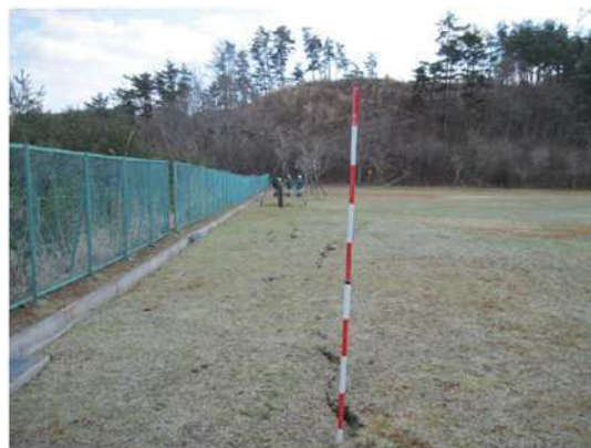
被害箇所② 法肩部の亀裂の状況
