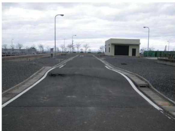
被害箇所③ 段差発生状況
