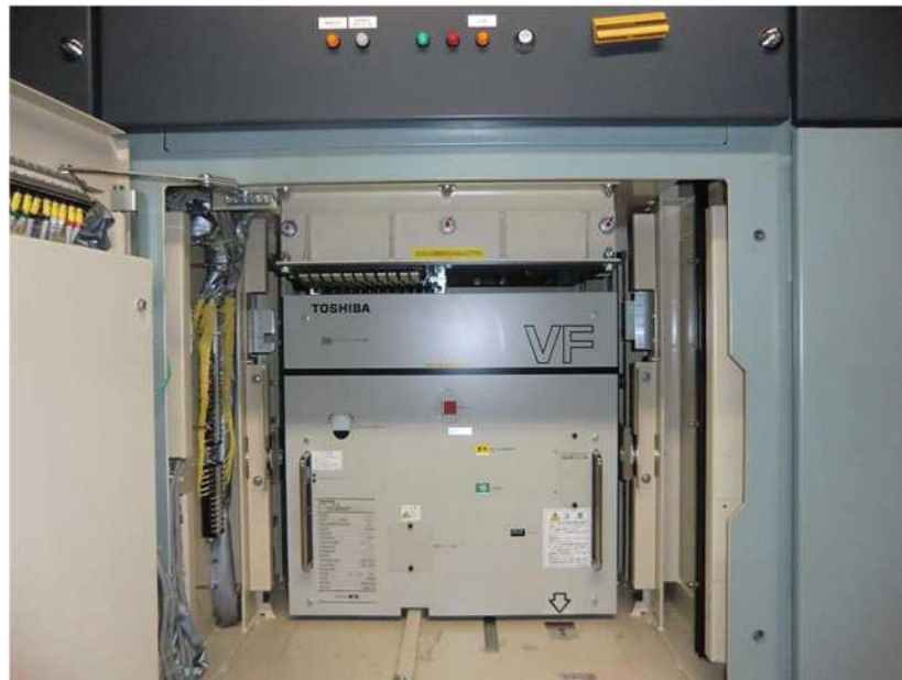
【対策後 VCB 遮断器】
