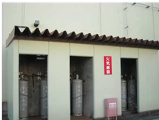
1号タービン発電機用ガスボンベ庫（水素ガス）
