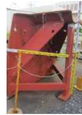
CS6_鋼製架台(3)
