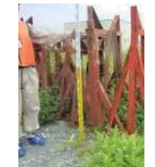
E4_鋼製架台(1)
