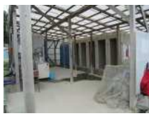
N5_仮設トイレ(1)
