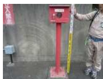
CS6_火災報知器格納箱
