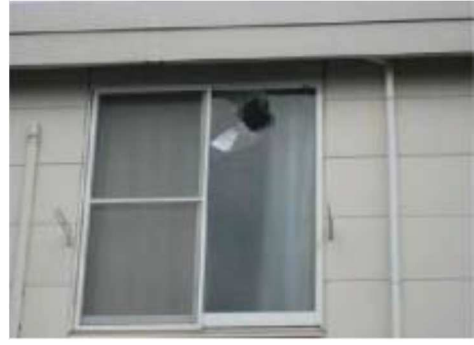
窓ガラスの飛来物衝突痕
