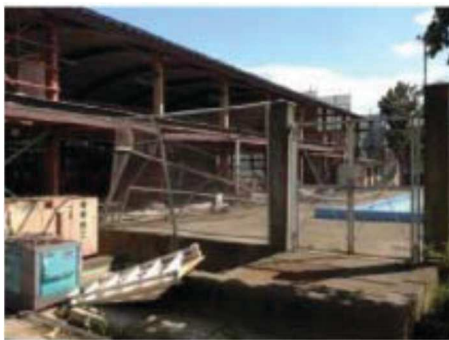
フェンスの被害（工事中の建築物）
