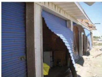
シャッターの被害
