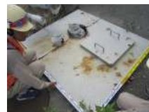
E3_鋼製ハッチカバー(2)
