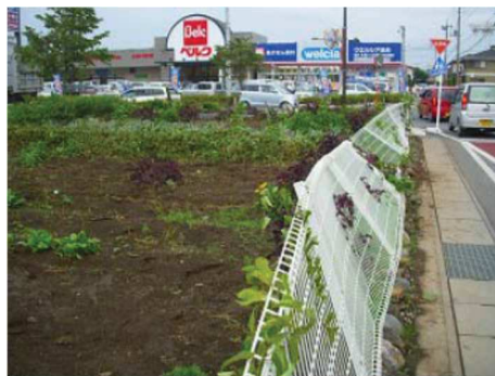
フェンスの変形
