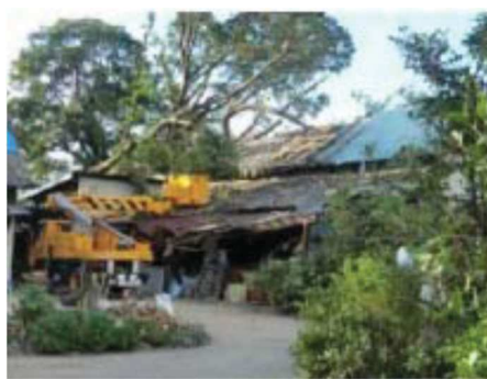
樹木の倒壊による小屋組の被害
