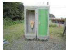
N5_仮設トイレ(2)
