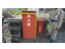
CS5_消火器格納庫(2)
