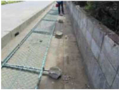
フェンスの倒壊
