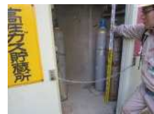
CS9_ガスボンベ
