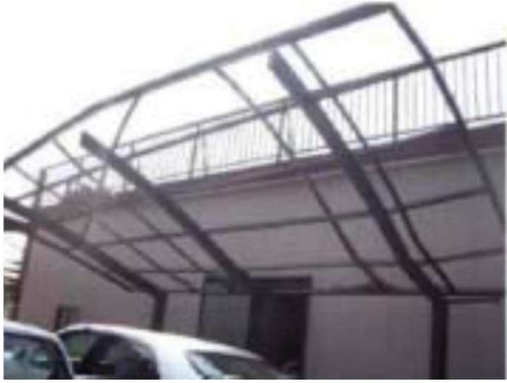
カーポート屋根の飛散及び骨組の損傷
