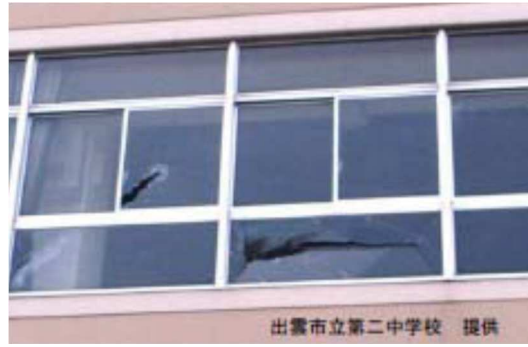
体育館窓ガラスの破損
