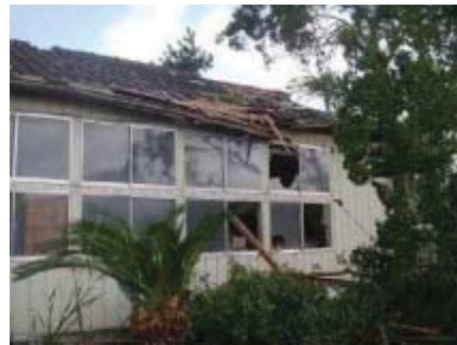
倉庫の窓ガラスと屋根の被害状況
