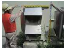
E3_業務用室外機(2)
