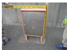
CS6_消火器格納庫(1)
