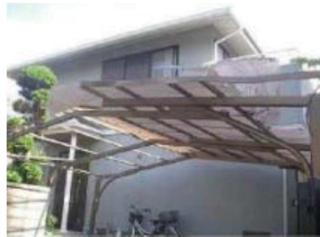
カーポートの被害
