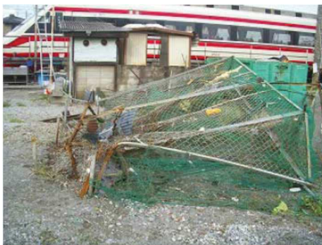
フェンスの著しい変形
