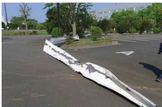
飛散した鋼板製屋根材
