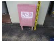
CS5_消火器格納庫(1)
