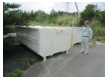
N2_鋼製容器
