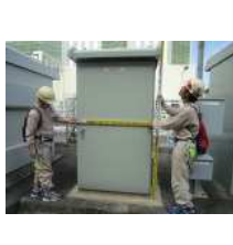
CS5_電気防食装置
