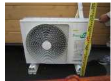
CN4_家庭用室外機(1)
