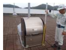
CS1_鋼製容器
