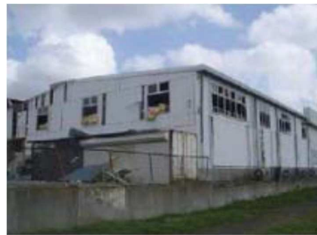
窓ガラスの破損
