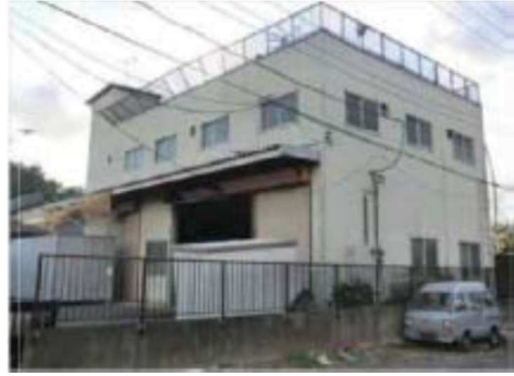
屋上フェンスの被害
