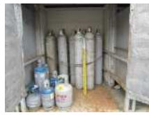
N3_ガスボンベ(1)
