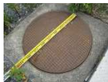
E3_マンホール蓋(2)
