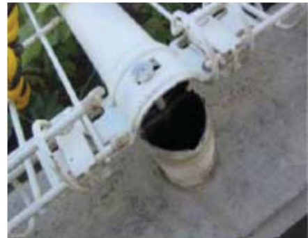
支柱部の破断
