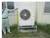
N2_業務用室外機
