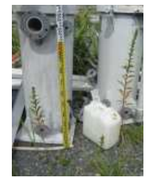
E4_鋼製タンク
