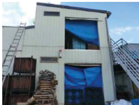
シャッターの被害
