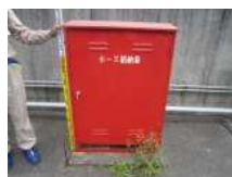
CS6_ホース格納箱(2)
