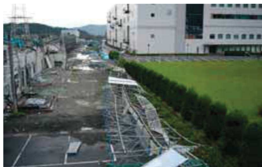
仮設足場の倒壊
