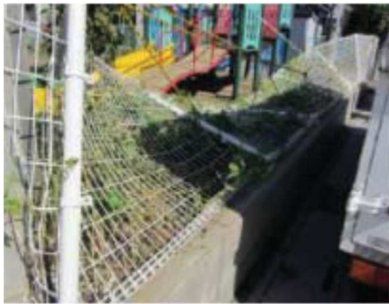
フェンスの倒壊
