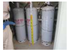
CS5_ガスボンベ
