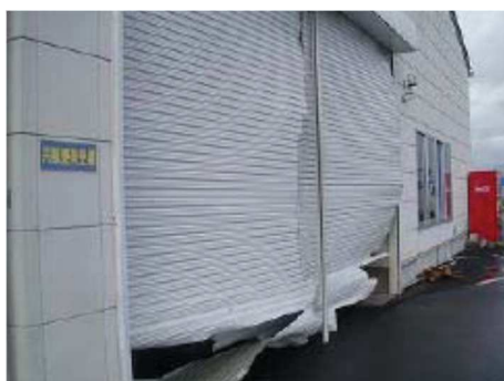
シャッターの破損
