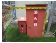
CS8_消火器格納庫(1)
