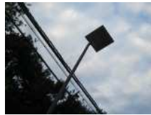
N6_屋外照明
