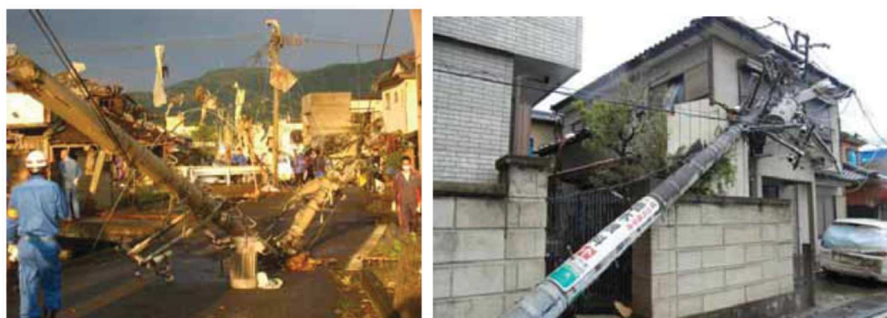
(電柱の折損, 傾斜)
