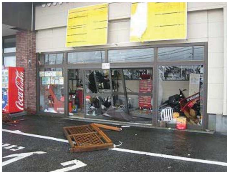
エントランスのガラス破損
