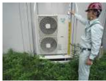
N4_業務用室外機
