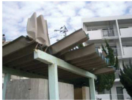
屋外トイレ屋根の損傷
