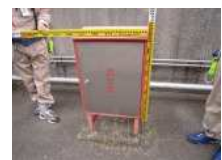
CS6_消火器格納庫(2)
