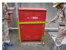
CS6_ホース格納箱(1)
