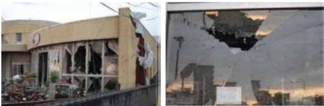
店舗の窓ガラスの被害状況
