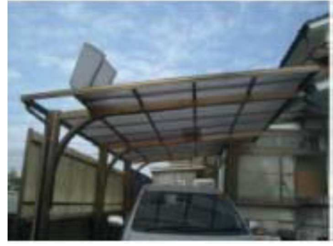
カーポート屋根の破損
