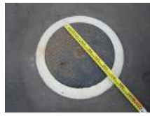
E4_マンホール蓋(1)
