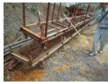
E4_鋼製架台(2)
