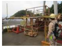
CS6_鋼製架台(1)
