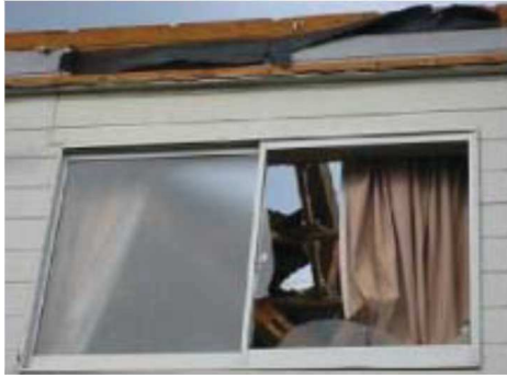
窓ガラスの損壊
