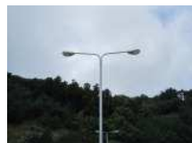
N2_屋外照明
