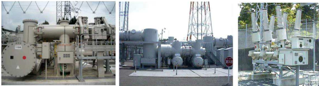
宮城中央変電所 (GIS)
