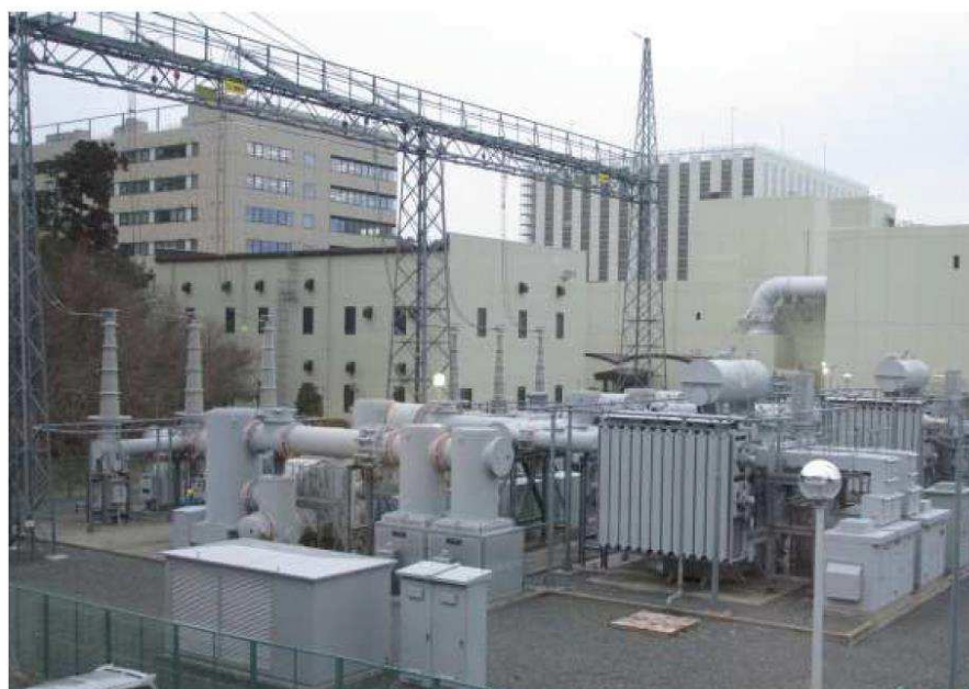
第 2.2.4-6 図 開閉所設備外観
