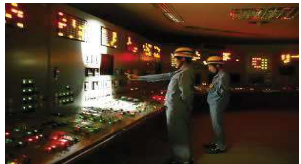
全照明消灯時
