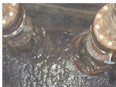
2号炉揚水ポンプの例(揚水井戸⑥)
