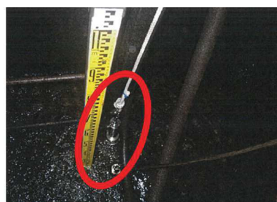
3号炉水位計の例(揚水井戸⑦)
