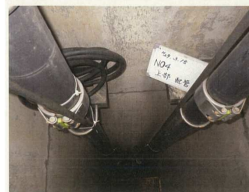
写真3-5 2号炉配管の例(揚水井戸④)
