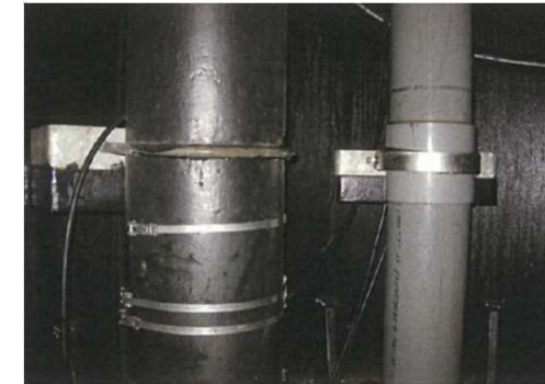
写真3-6 3号炉配管の例(左側) (揚水井戸⑦)
