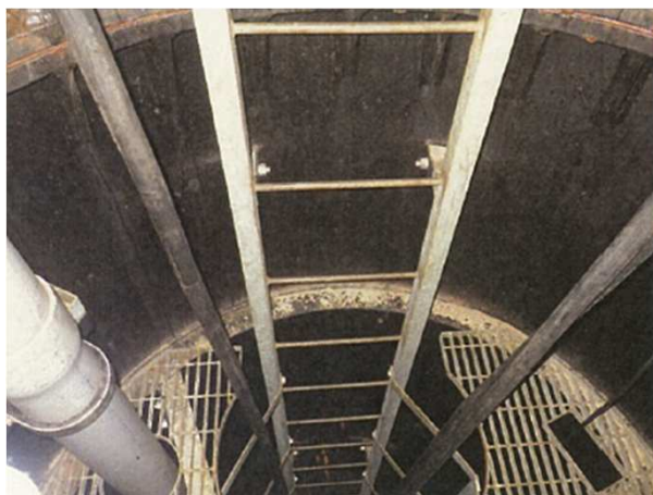
写真B 揚水井戸⑦(中間部) 2017/3/16撮影
