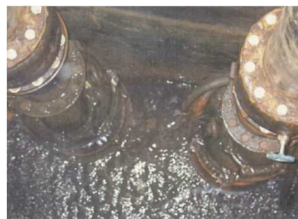
2号炉揚水ポンプの例(揚水井戸⑥)
