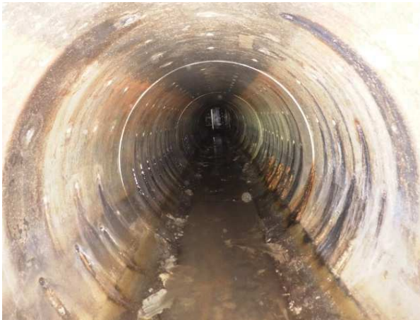
写真A ドレーン(有孔ヒューム管Φ1,050mm) 2018/9/18撮影
