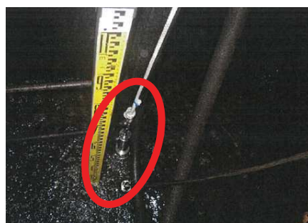
3号炉水位計の例(揚水井戸⑦)
