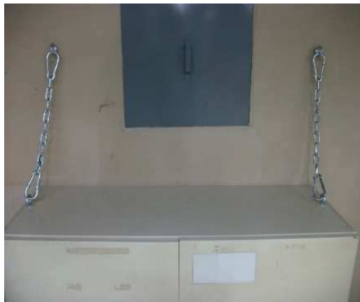
転倒防止処置確認例
