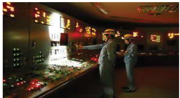
全照明消灯時
