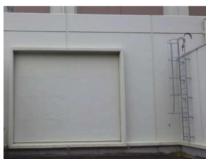
BOP外観（屋外から撮影）
